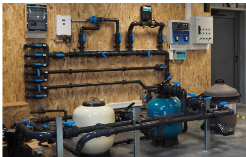
Local technique du bassin extérieur (3 filtres : sable, verre et diatomées)
